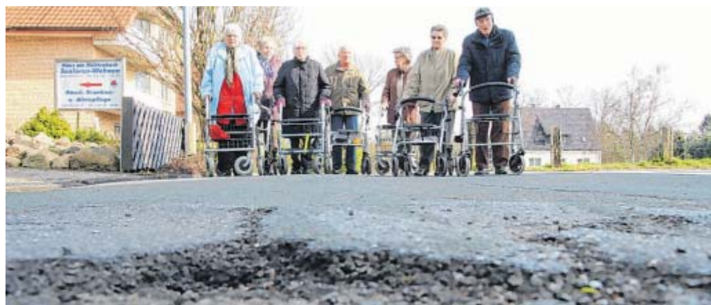
Hindernis: Bewohner eines Seniorenheims beklagen den Zustand der Schierholzstraße.
